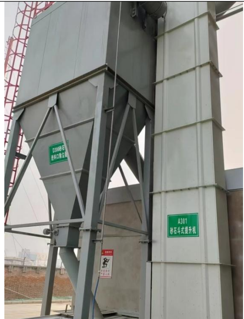
砂石进料除尘器
