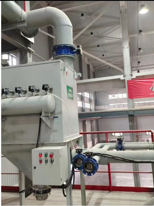
包装工序除尘器
