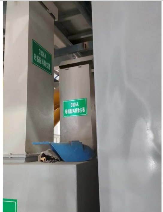
配料工序除尘器
